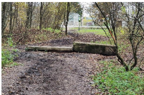
Участок дорожно-тропиночной сети в неудовлетворительном состоянии
